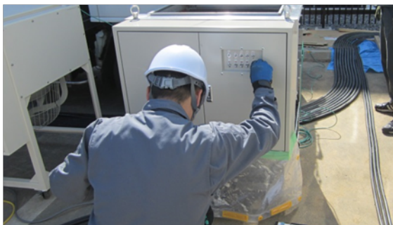
▲ 某大学構内・低圧発電設備の能力検証
