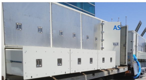
▲ 某通信基地局・発電設備の能力検証
